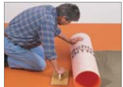
9 Verlegung der Entkopplungsmatte Schlüter®-DITRA 25 in frischem Dünnbettmörtel nach Begehbarkeit des Estrichs (nach ca. 2–3 Tagen). Bei Calciumsulfatestrich nach einer Restfeuchte von \leq 2\% .
